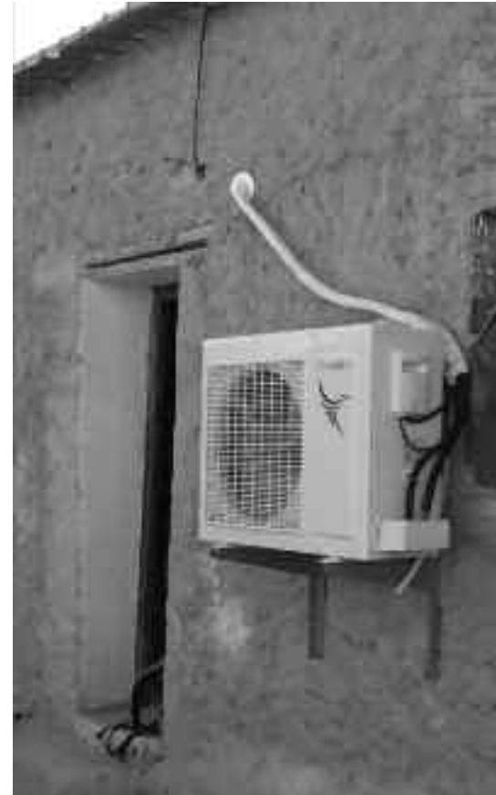
Notre salle dispose depuis mai de la climatisation !
